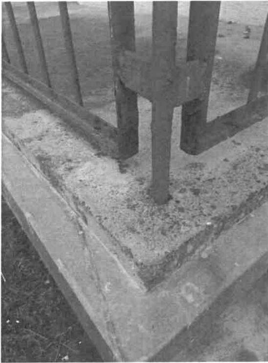
Przebicie posadzki cementowej słupkiem balustrady
