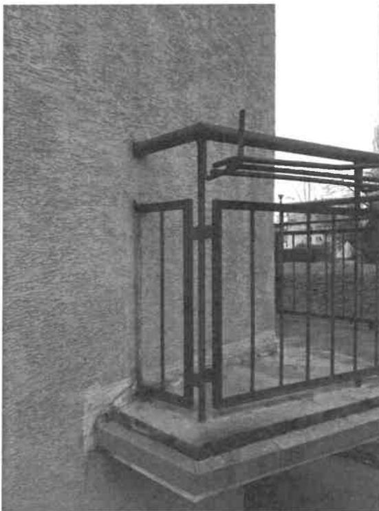
Wtopienie istniejącej balustrady w docieplenie ścian zewnętrznych
