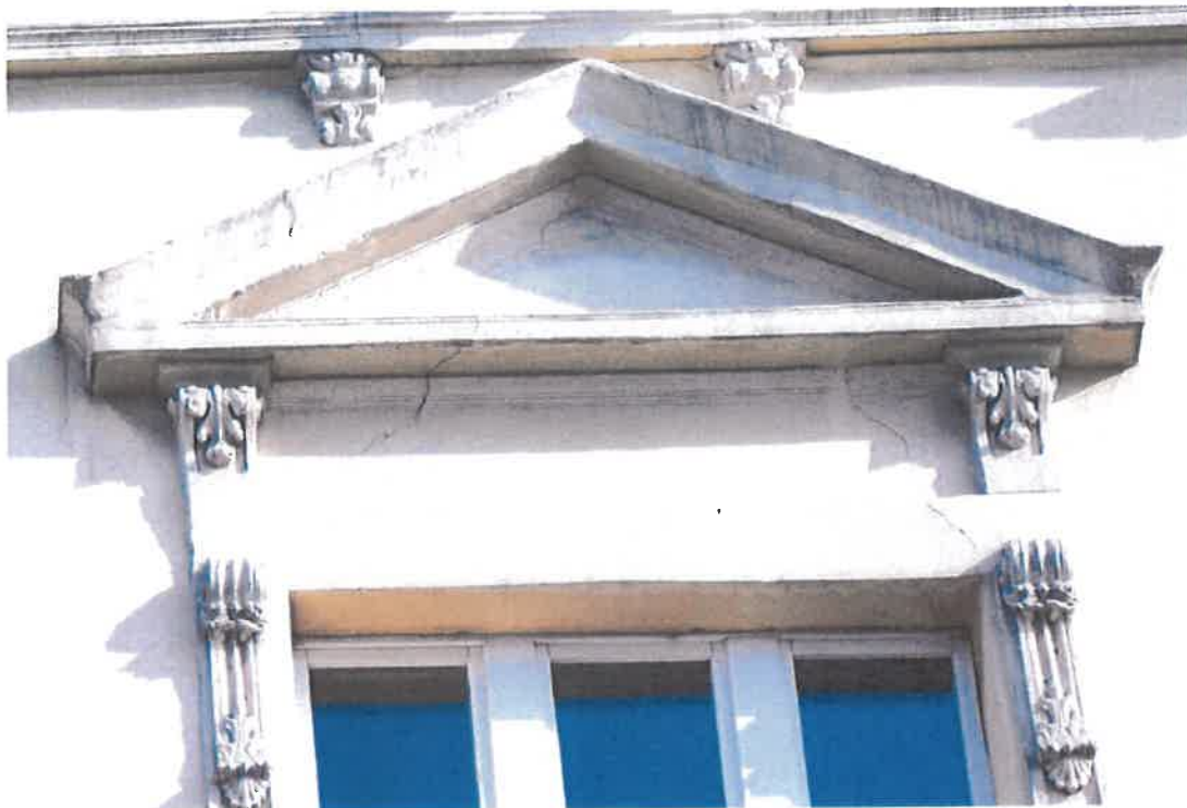
Zdj. nr 16. Pokazano naproże i gzyms przewidziane do naprawy przy pomocy zaprawy iniekccyjnej cd.
