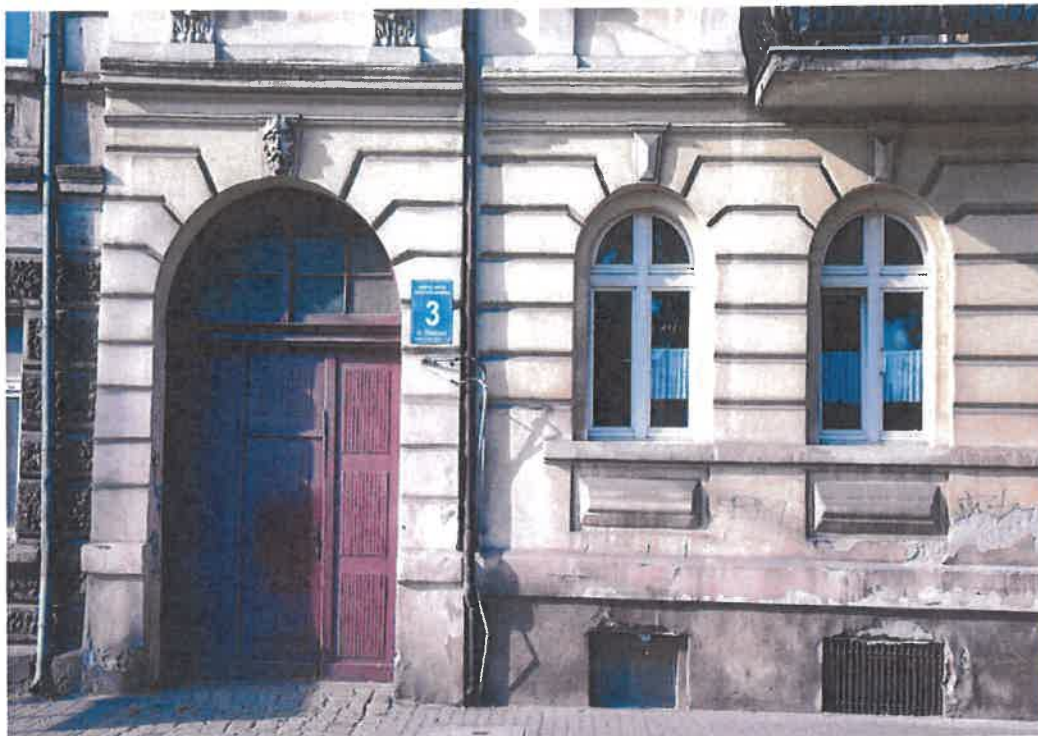
Zdj. nr 4. Widoczne zniszczenia elewacji w poziomie cokołu przy drzwiach przejazdu.
