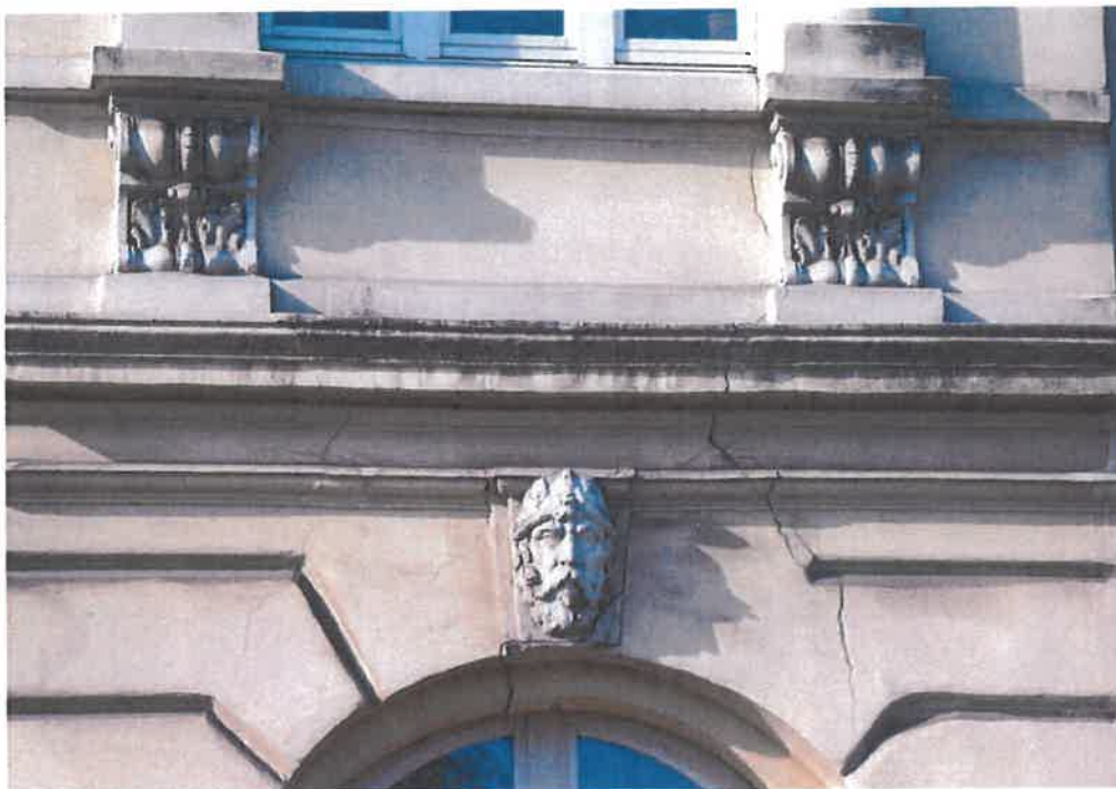
Zdj. nr 11. Widoczne uszkodzenia strefy podokiennej, gzymsów oraz nadproży okiennych.
