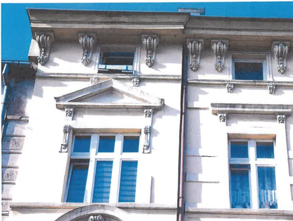
Zdj. nr 13. Widoczne uszkodzenia nadproży okiennych oraz gzymsu skrzynkowego.
