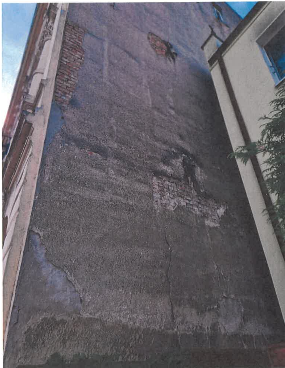
Zdj. nr 10. Widoczne ubytki tynku na elewacji szczytowej.
