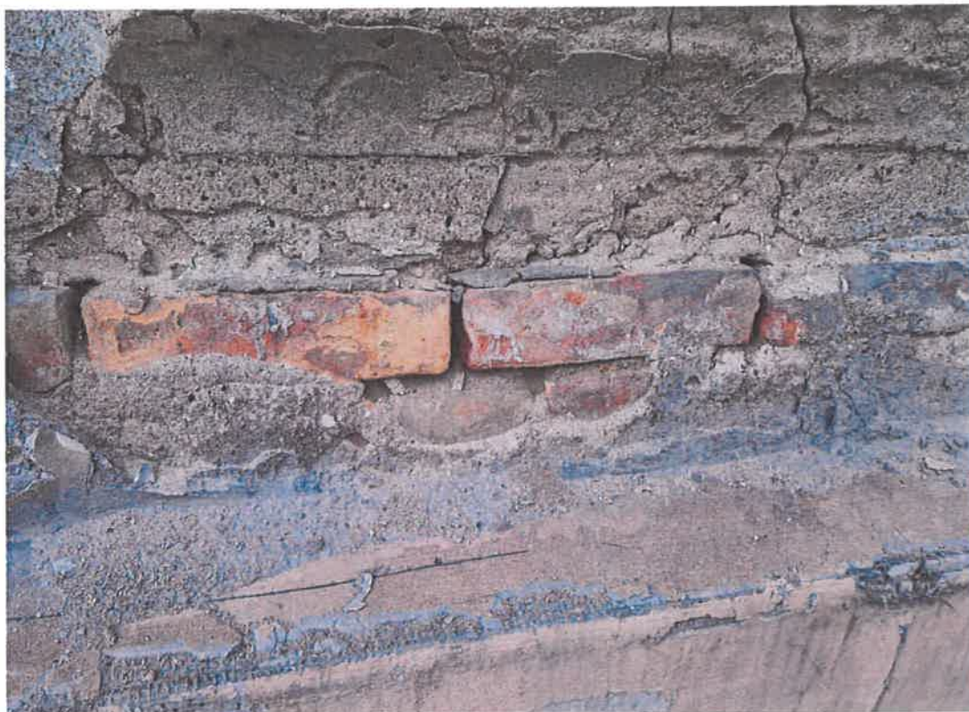
Zdj. nr 8. Widoczne ubytki tynku w poziomie parteru, brak spoin pomiędzy ceglami cd
