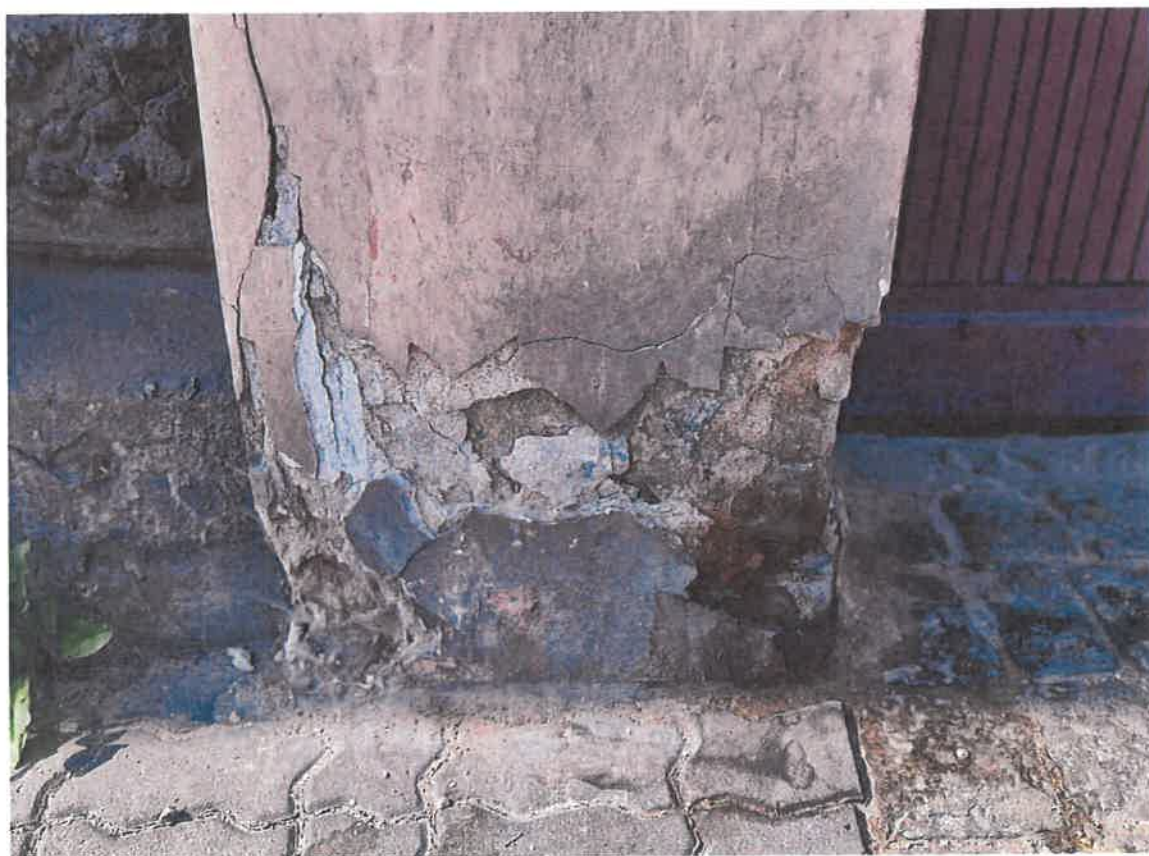
Zdj. nr 9. Widoczne ubytki tynku przy wejściu do budynku, silne zawilgocenie muru.
