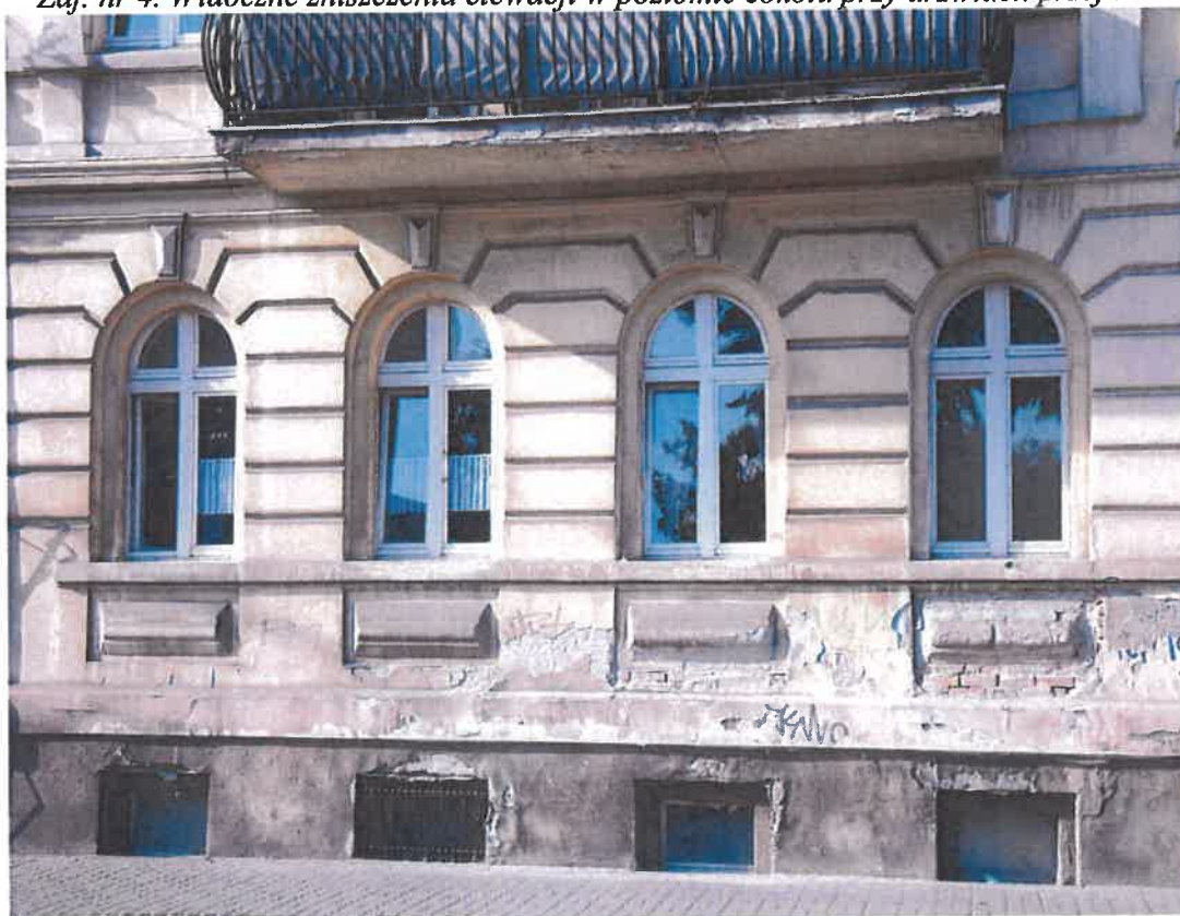
Zdj. nr 5. Widoczne zniszczenia elewacji w poziomie cokołu pod balkonami.
