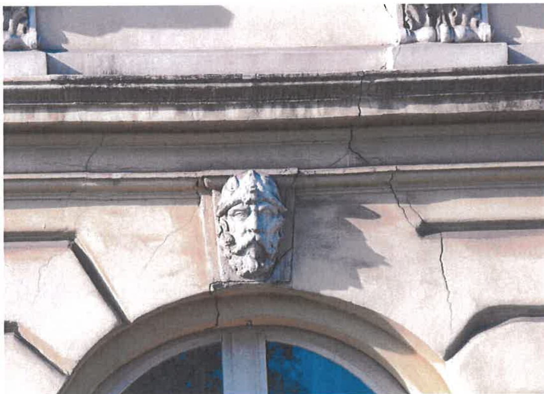
Zdj. nr 15. Pokazano nadproże i gzyms przewidziane do naprawy przy pomocy zaprawy iniekcyjnej.
