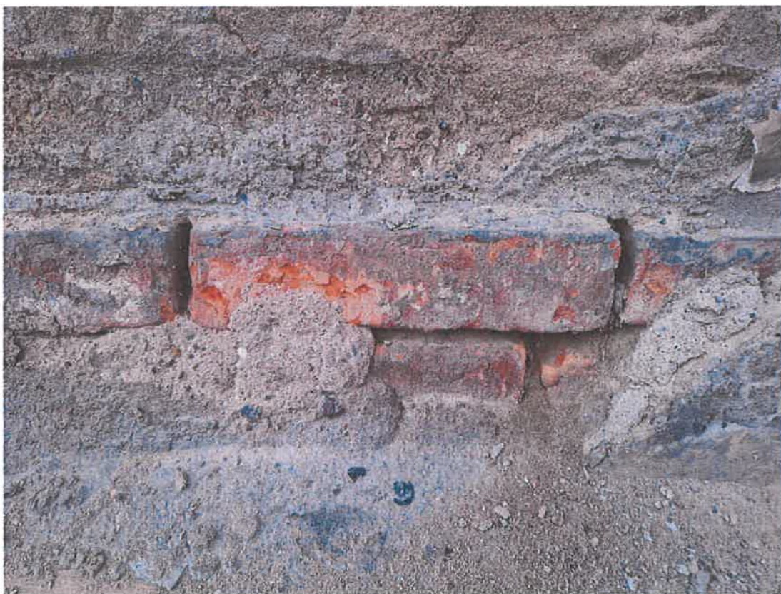
Zdj. nr 7. Widoczne ubytki tynku w poziomie parteru, brak spoin pomiędzy ceglami.
