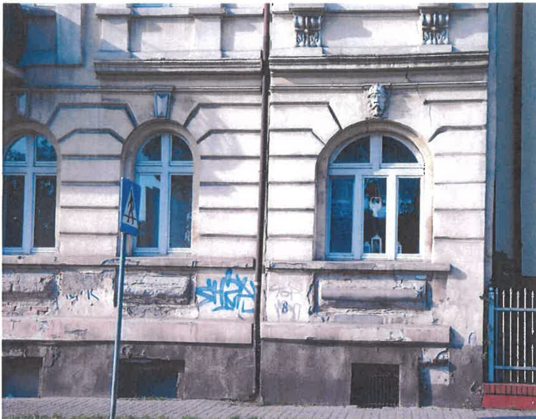
Zdj. nr 6. Widoczne zniszczenia elewacji w poziomie cokołu cd.
