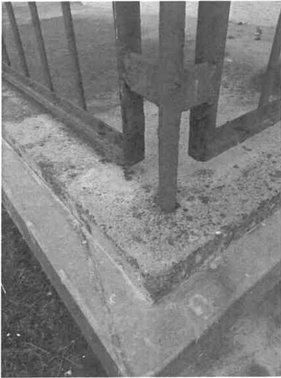
Przebicie posadzki cementowej słupkiem balustrady
