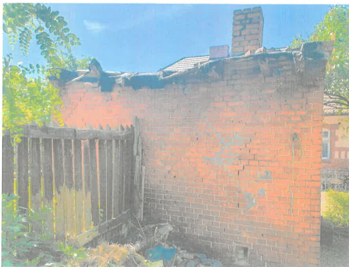
Zdj.1. Budynek gospodarczy przewidziana do rozbiórki, konstrukcja dachu zniszczona, mury zarysowane.
