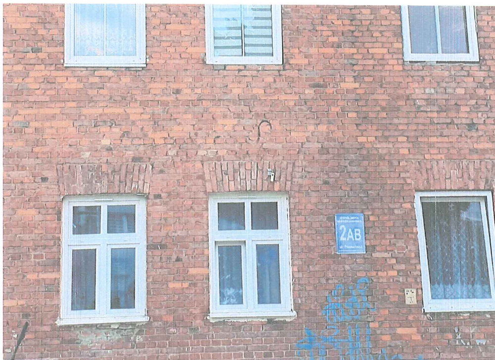
Zdj.14. Mur podłużny widoczna kotew – pozostałość po ankrowaniu stropu.
