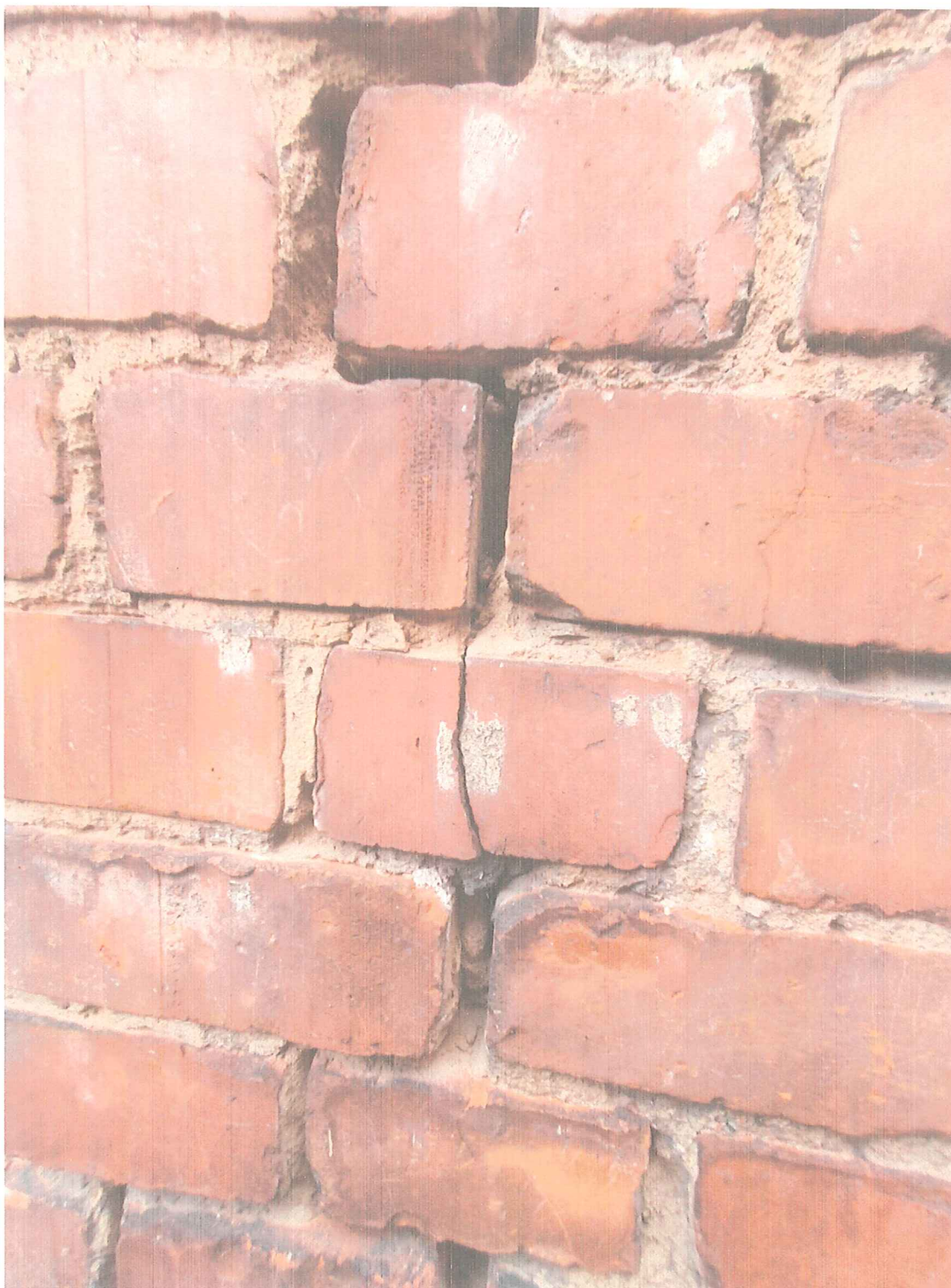
Zdj.7. Widoczne rozwarstwienie muru wraz z ubytkiem spoiny, uszkodzenie cegły w postaci zarysowania - pęknięcia pionowego. (od strony podwórza budynku).
