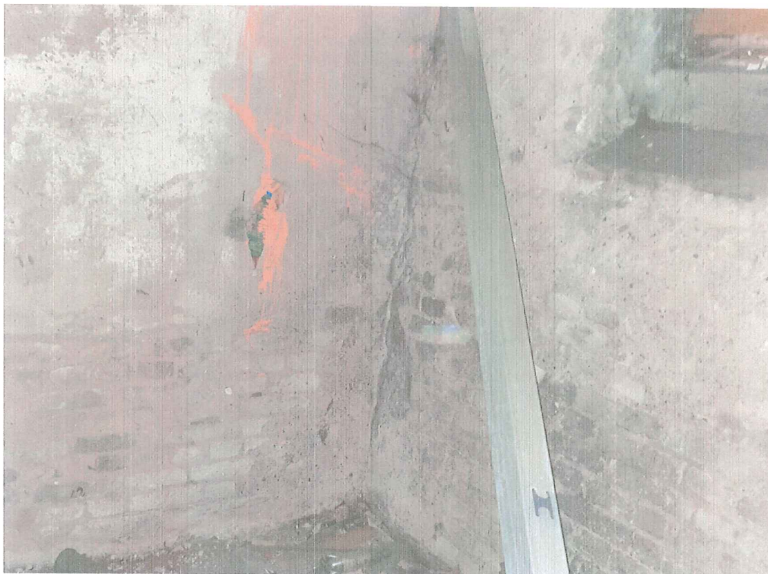
Zdj.12. Mur w piwnicy widoczne zarysowania na połączeniu z murem zew.
