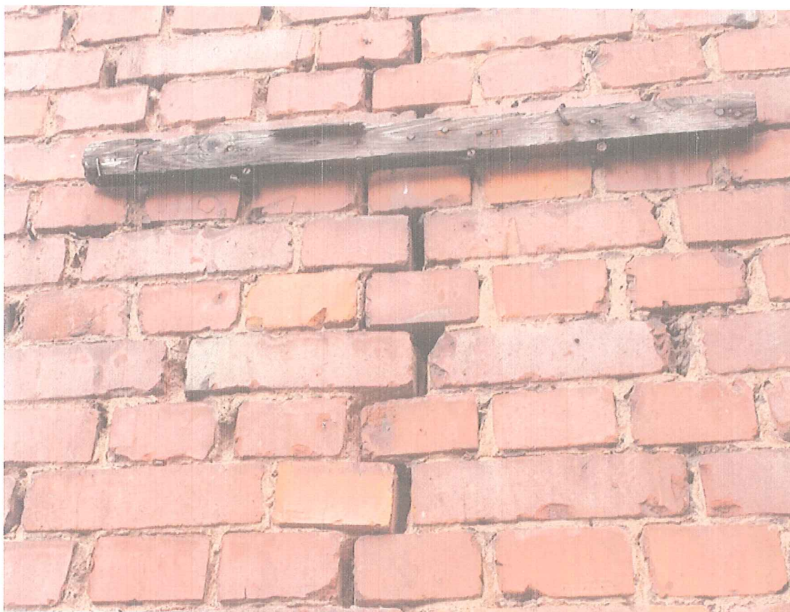
Zdj.6. Widoczne rozwarstwienie muru w miejscu połączeniu segmentów budynku.cd. (od strony podwórza budynku).
