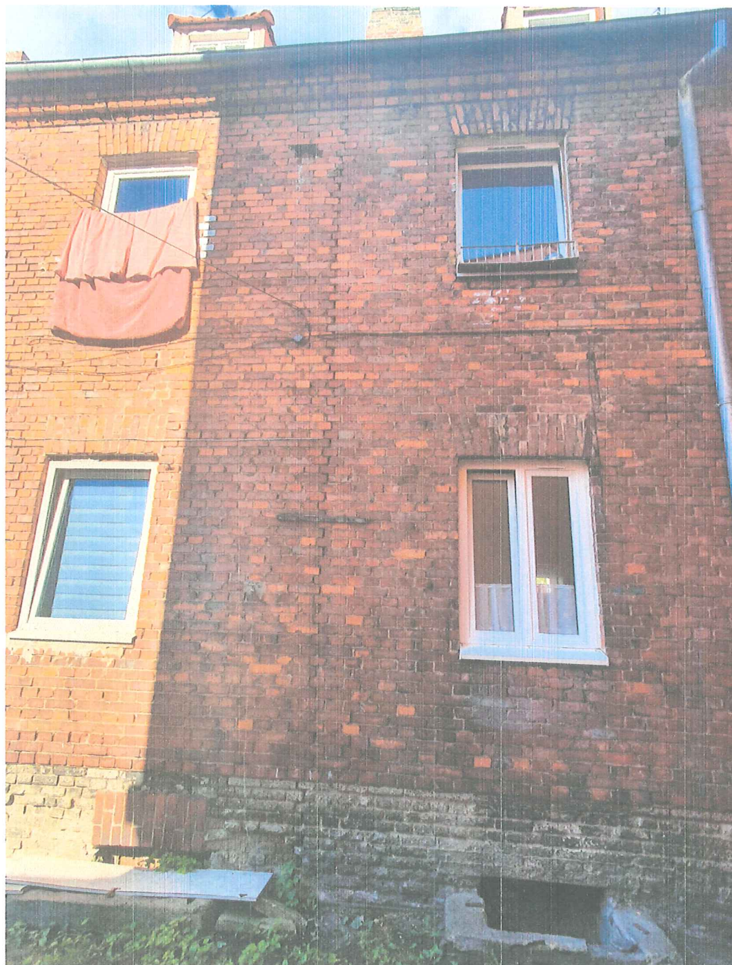
Zdj.4. Widoczne rozwarstwienie muru w miejscu połączenia segmentów budynku, od strony podwórza budynku.
