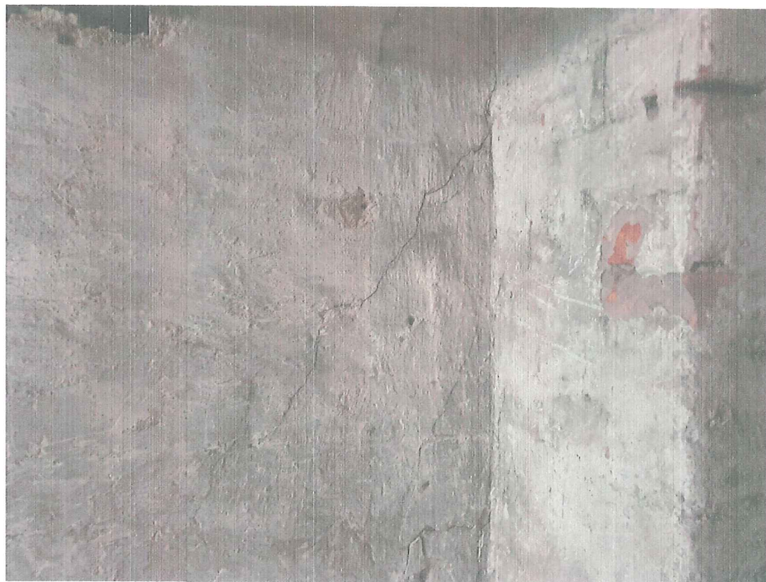
Zdj.13. Mur w piwnicy widoczne zarysowania na połączeniu z murem wew.
