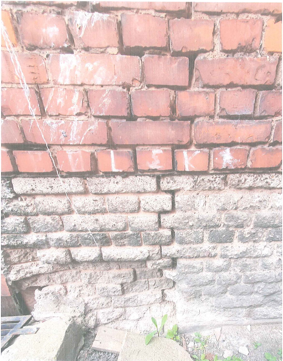
Zdj.8. Widoczne rozwarstwienie muru wraz z ubytkiem spoiny, cegły silikatowe skruszałe (od strony podwórza budynku).
