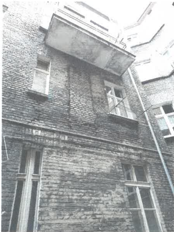
Zdjęcie nr 5. Widok oficyny od zewnątrz. Widać przecieki i spękania z płyty balkonowej. Rozebrano płytę balkonową lokalu 4a.
