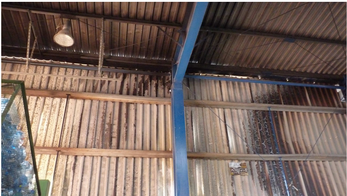
Fot. 2 Widok konstrukcji wewnątrz budynku w strefie przylegającej do miejsca pożaru
