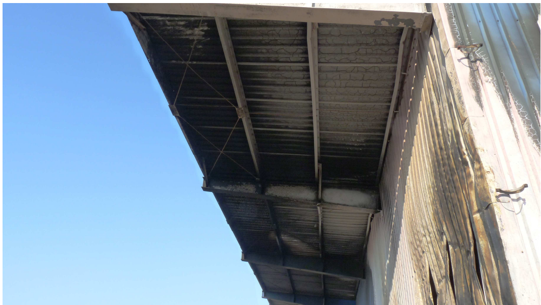
Fot.8 Zadaszenie w miejscu powstania pożaru
