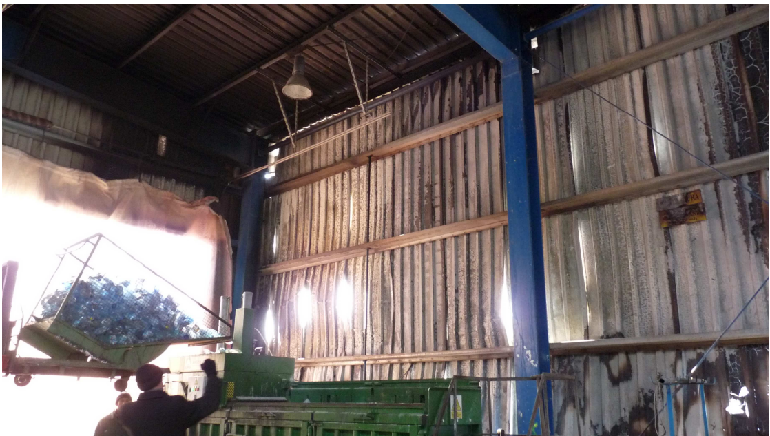
Fot. 4 Widok konstrukcji wewnątrz budynku w strefie przylegającej do miejsca pożaru
