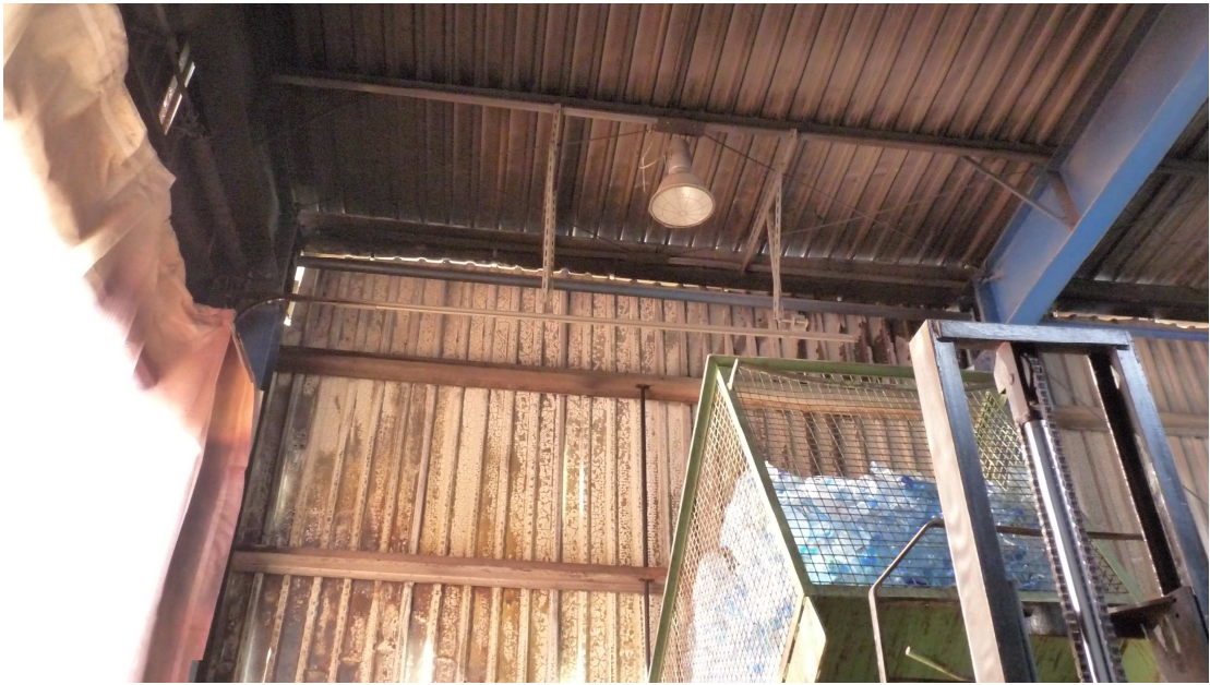
Fot. 3 Widok konstrukcji wewnątrz budynku w strefie przylegającej do miejsca pożaru
