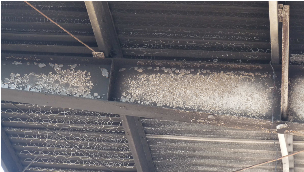
Fot.7 Widok konstrukcji zadaszenia w miejscu powstania pożaru
