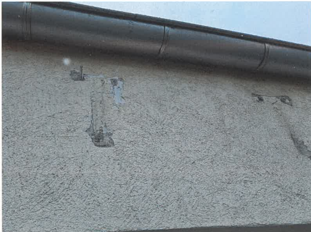
Zdj.10. Widoczne uszkodzenia elewacji, daszek został zdemontowany cd.
