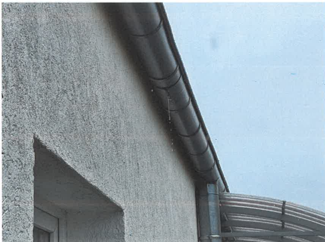
Zdj.11. Widoczna nieszczelność rynny wyniku.
