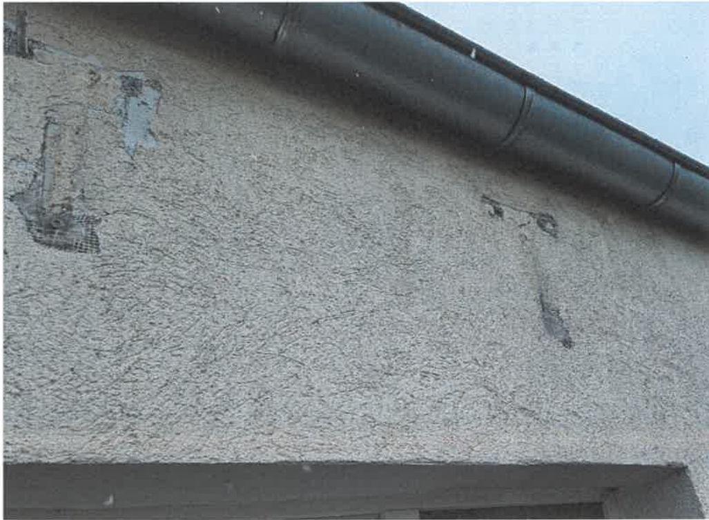
Zdj.9. Widoczne uszkodzenia elewacji, daszek został zdemontowany.
