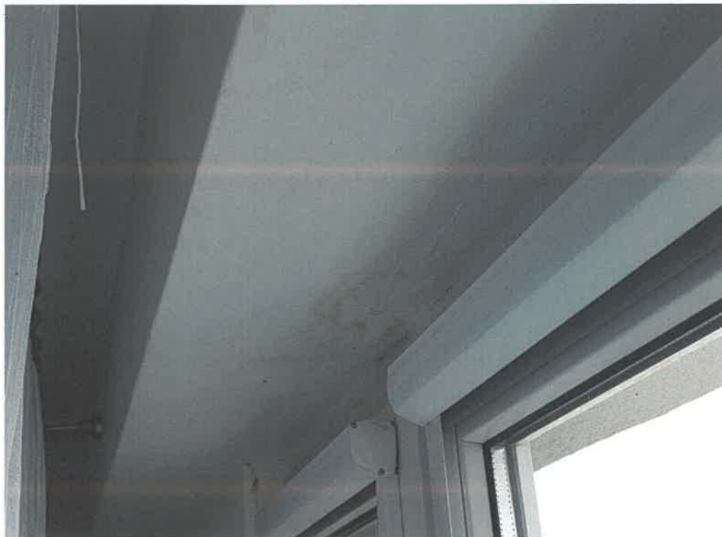
Zdj.10. Widoczne zalanie nadproża wyniku wiania się wody za warstwę izolacji termicznej
