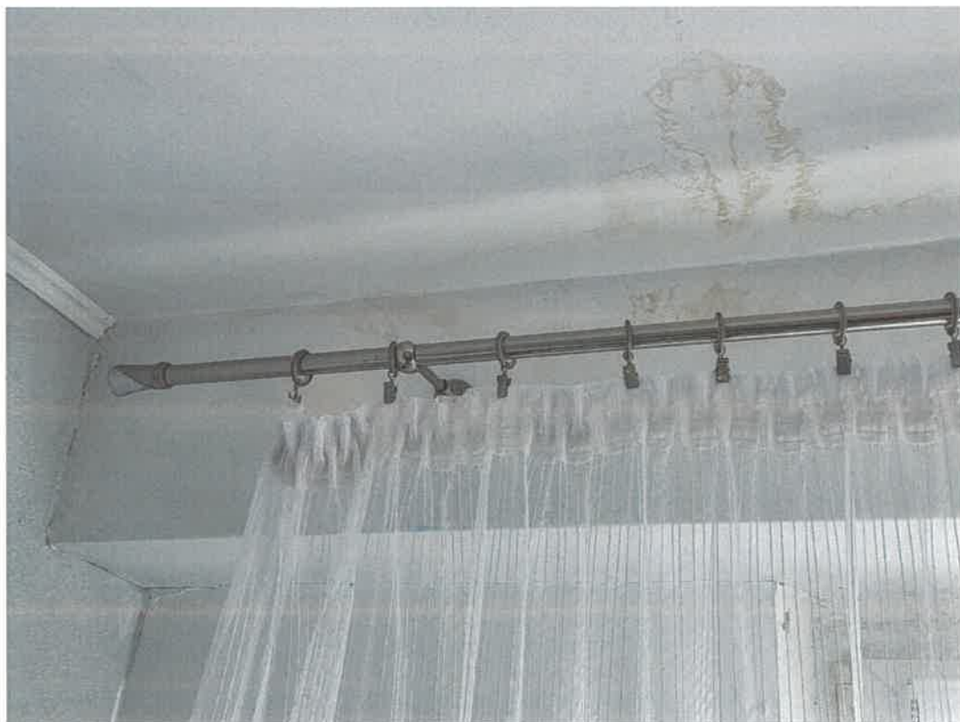
Zdj.9. Widoczne zalanie sufitu oraz nadproża.
