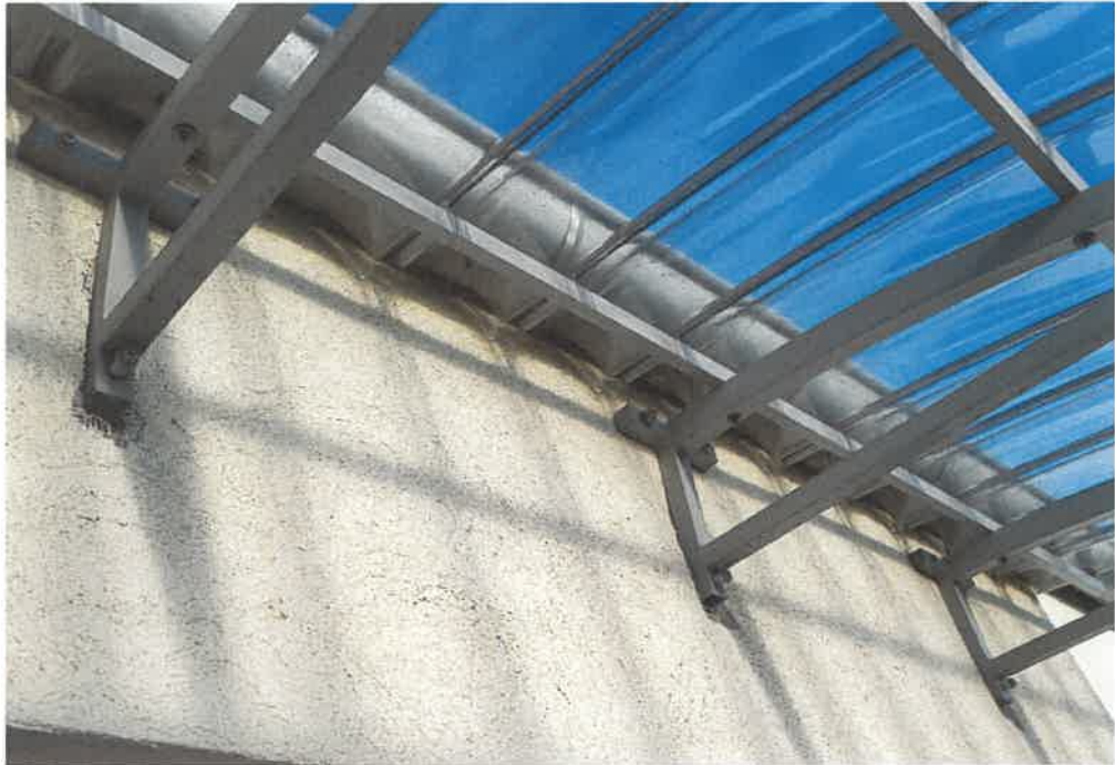
Zdj.7. Uszkodzenia elewacji powstałe wyniku zapadnięcia się w warstwie tynku cienkowsarstwowego oraz izolacji termicznej cd.
